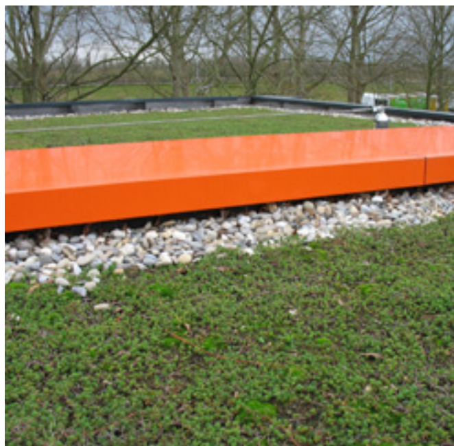
Energydak aangebracht onder een mos sedum dak waardoor o.a. koeling kan worden gewonnen uit het dak
