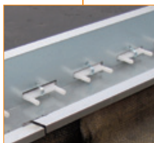
Goot op dak met collector-uiteinden
